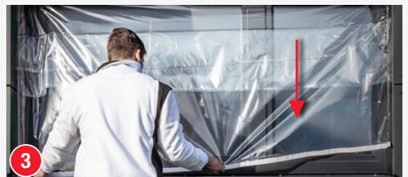
3 Die Folie nach unten ausziehen und mit dem Klebestreifen ankleben. Abschließend die mittlere Haftzone auf der Fensterscheibe andrücken.
